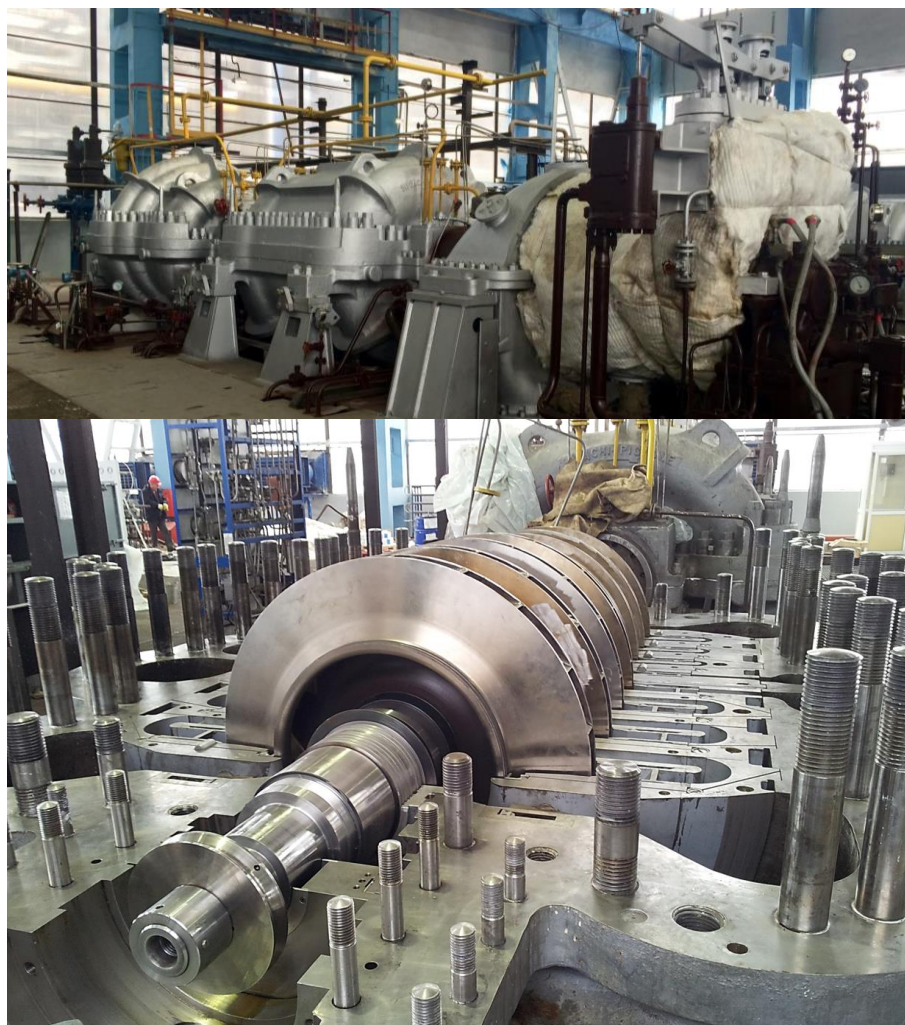
Рис. 1. Общий вид турбокомпрессорного агрегата поз. 105J/JT (слева направо: ЦНД, ЦВД и турбина) и модернизированных узлов
